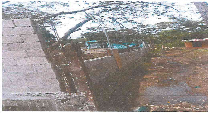
Foto 3: pared lado derecho del predio de la escuela donde esta a mitad del proceso de reparación
