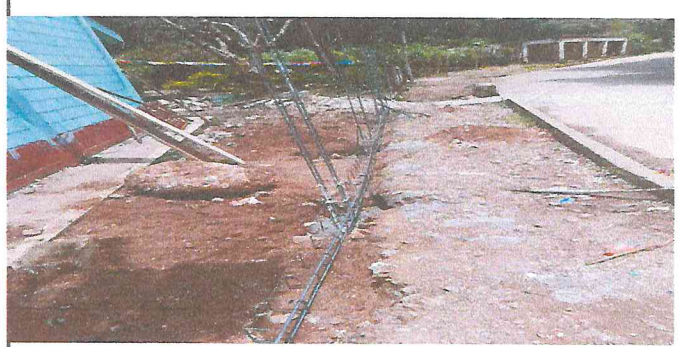
Foto 2: Pared del frente de la escuela donde esta en proceso de reparación.
